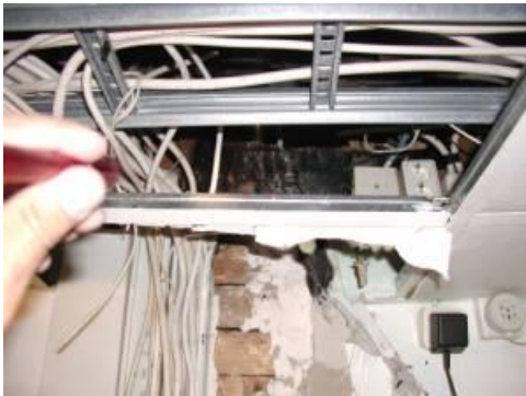
En rejäl härva av el-ledningar som löpte kors och tvärs i utrymmet.
