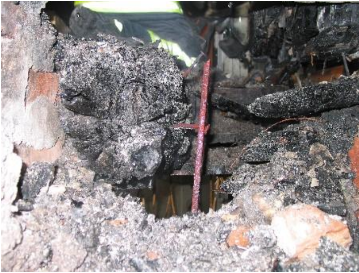
Plattjärnet som kapades samt bjälken där branden startade. Lägenheten under skymtar genom hålet under bjälken.
