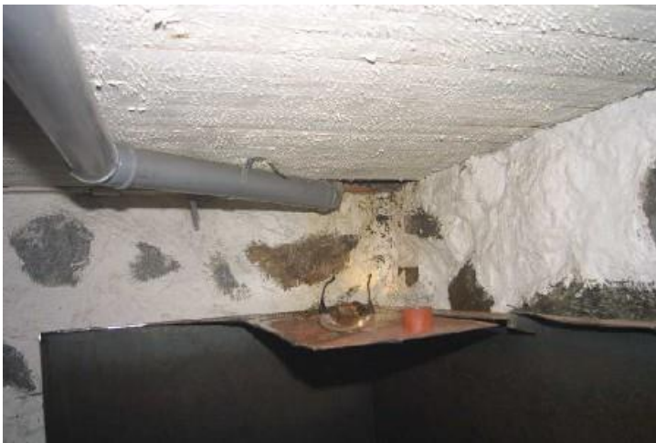
Hålet i bjälklaget där gnistorna sprutade in.
