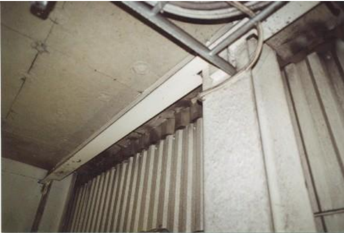
Tätningen av väggens överdel saknas.
