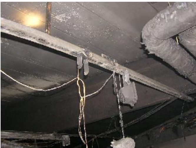
Armaturer samt kabelskena som fanns ovanför primärområdet. I anslutning till primärbranden hade kabelskenan vikt ned sig
