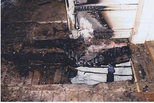
Det uppsågade hålet i golvet vid brandskadan.
