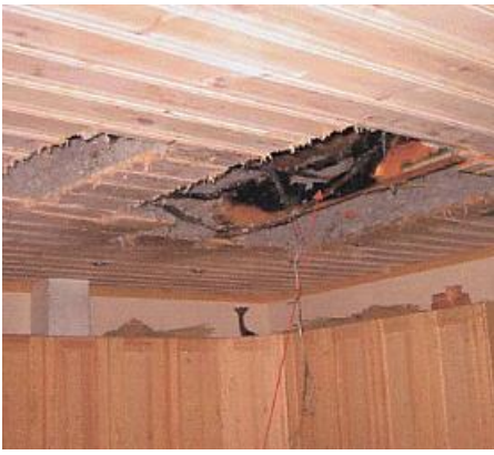
Här låg den transformator som startade branden.
