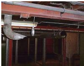
Källarplan. Till vänster ventilationsrör från maskinen.
