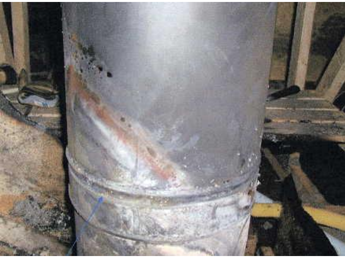
Skortensskarven. Innanför plåten hade silikon anbringats för att få tätt i skarven.
