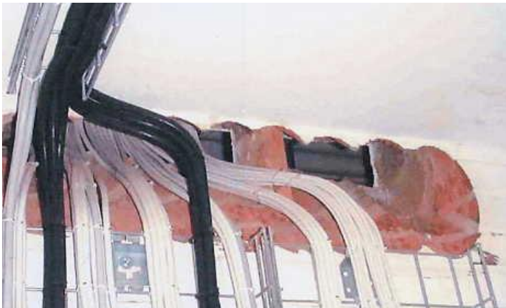
Otät genomföring från elcentral till lager.
