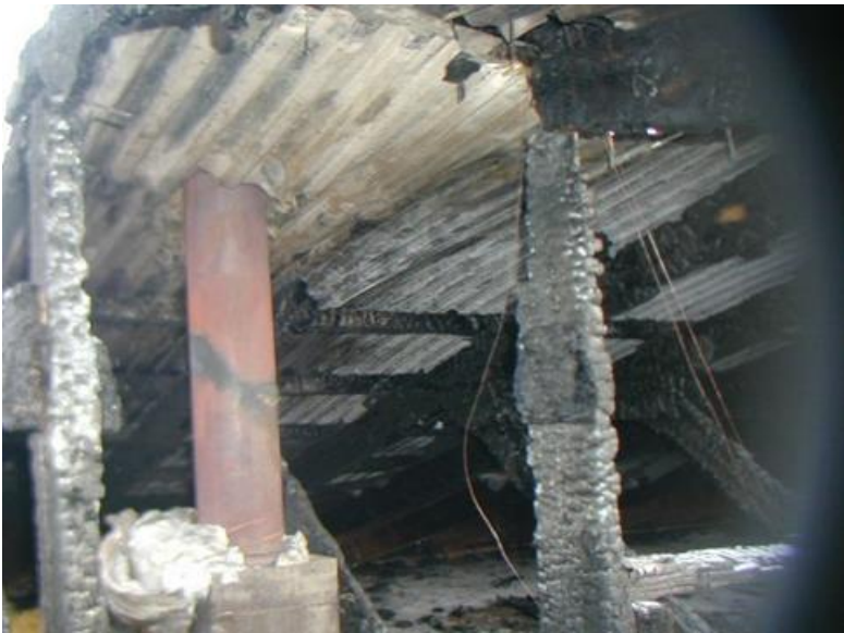
Skorstensröret ligger helt öppet sista biten, utan isolering eller skyddsplåt.
