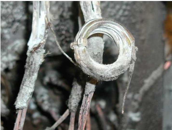
Här syns avbrottsstället på den brunna pannans kapillärrör.
