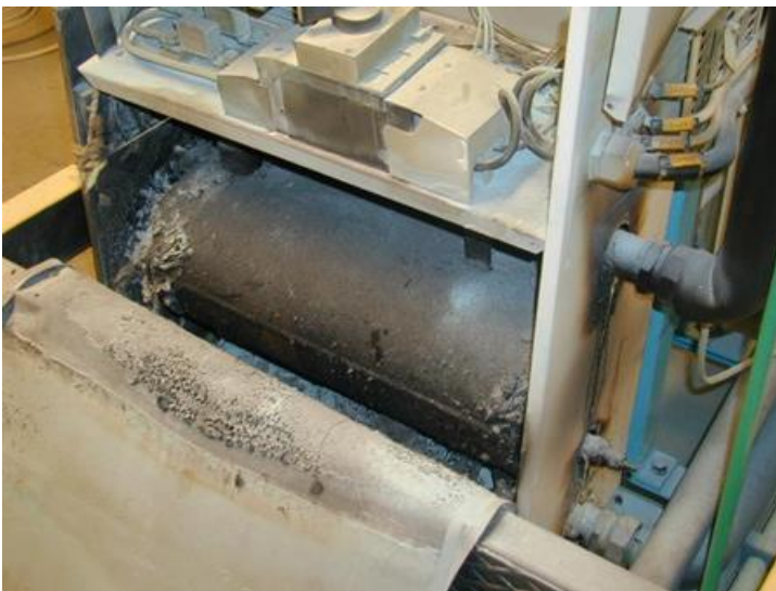
Vattenbehållaren som överhettades. All omliggande isolering har smält bort.
