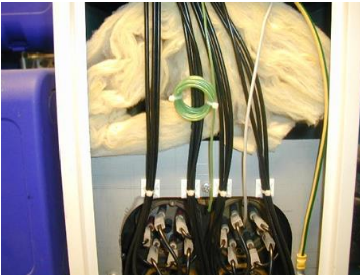
Referenspanna. Här syns överhettningsskyddet. Även kapillärröret finns i bild.
