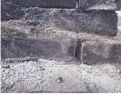
Otät fog där värmespridning till träregel sannolikt startade branden.
