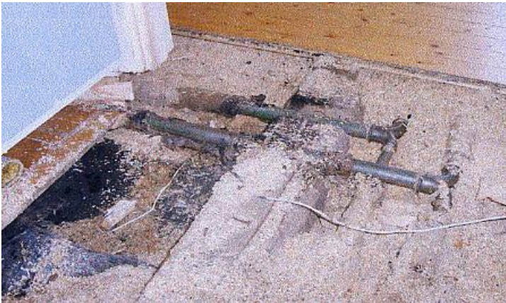
Branden startade vid en balk som vattenrören gick igenom samt spån som isolerade.
