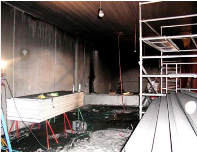
Sot, sot så långt ögat kunde se. Området omedelbart utanför kulverten.
