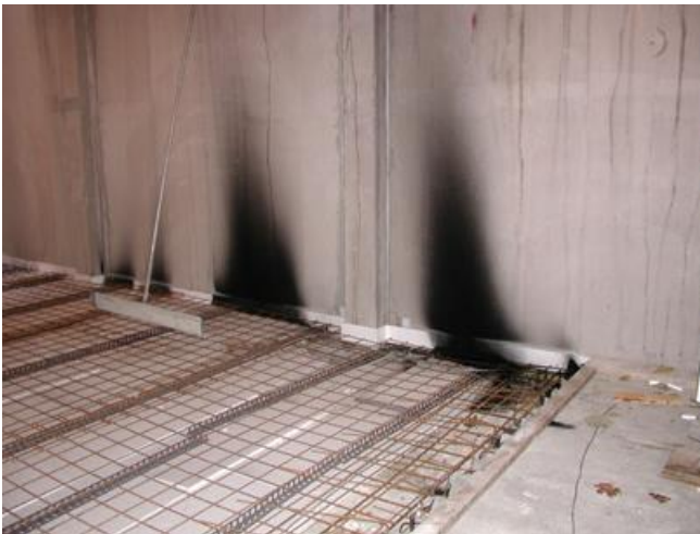
Sotet har trängt upp till andra plan på byggnadens motsatta sida.
