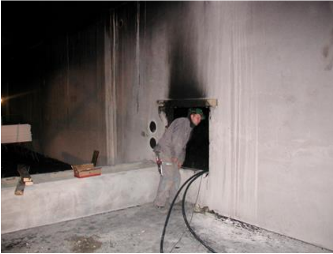
En öppning mot den helt utbrända kulverten.
