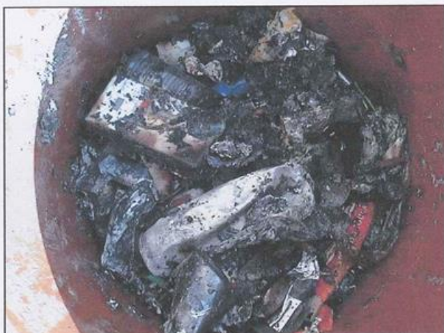
Brandresterna från ventilationstrumman
