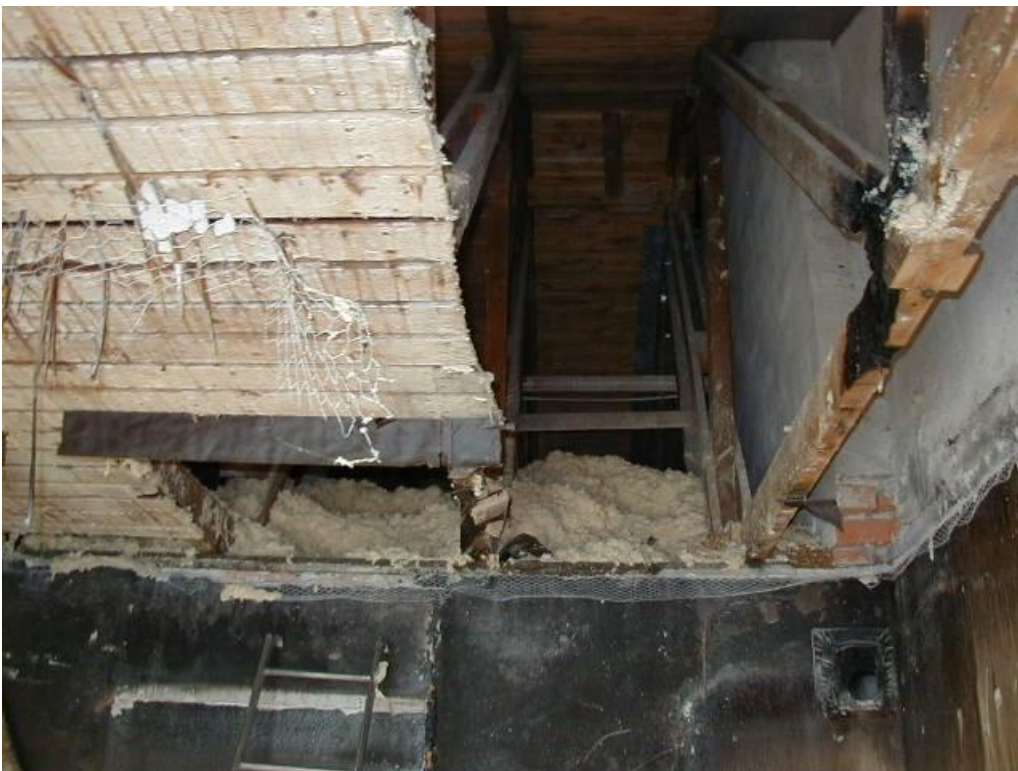
Den brandavskiljande vindsväggen (till höger i bild) mot fyra lägenheter i nästa trapphus .
