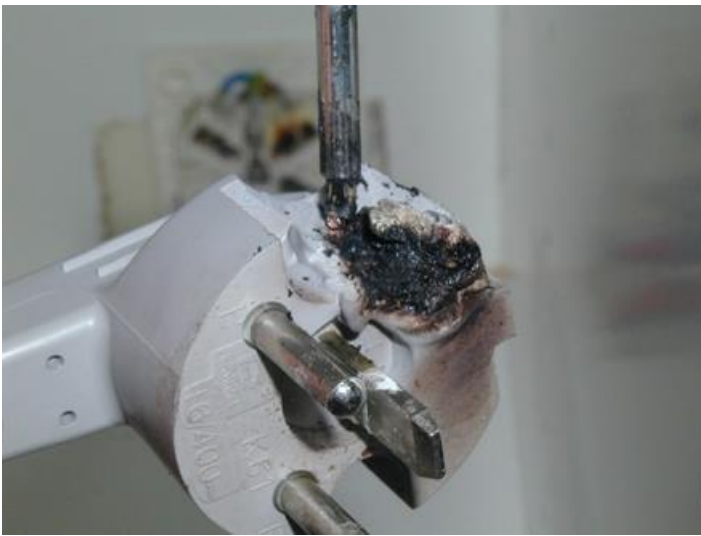
Här syns överledningskadan på ett av fasstiften i kontakten.
