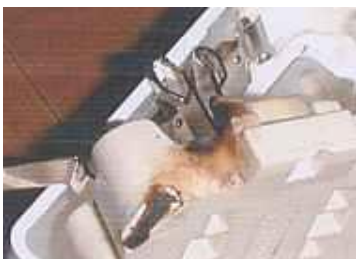
Vägguttagets baksida med bränt parti efter den klämda sladden.
