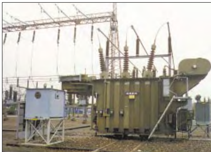
En transformator på 130-20 kv innehållande cirka 30 kubikmeter olja. Vid en brand finns alltid risk att höljet spricker och oljan antänds. Sprutas vatten ner i den brinnande oljan kan ångbildningen kasta ut olja och förvärra branden.
