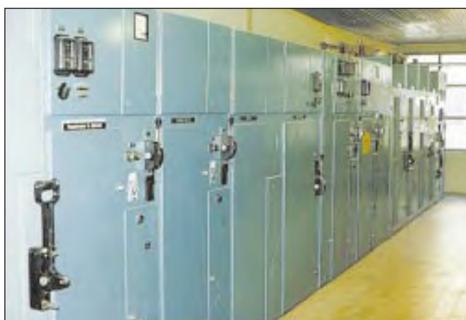
Ett 10 kv inomhus ställverk av äldre modell.
