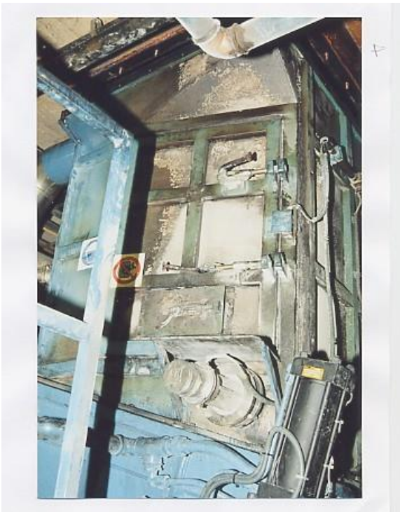
TVå h rdugnar f r kv veh rdning, explosionen intr ffade i den v nstra ugnen.
