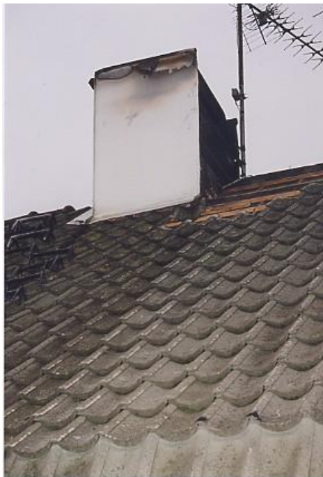
Plättneslutning av skorstenen, värme- anlöpfung av plåten i toppen.
