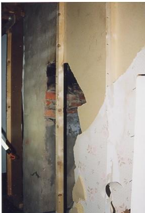
Vägg på vinden fick rivas av räddnings- tjänsten. I bakgrunden syns de blindschakt där branden spridit sig till vinden.
