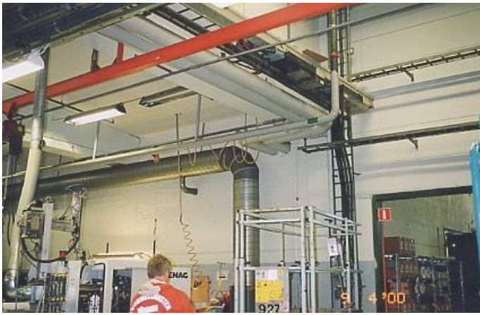
Inkommande elledning till maskinlinje. Hållare för knivsäkringar i taket.
