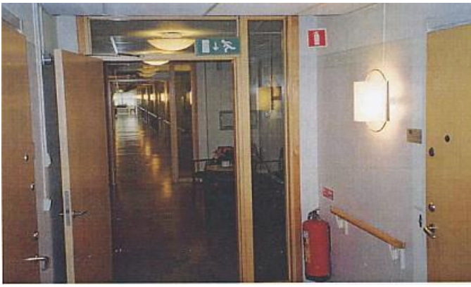
Brandavskiljande parti i korridor förhindrade rökspridning.
