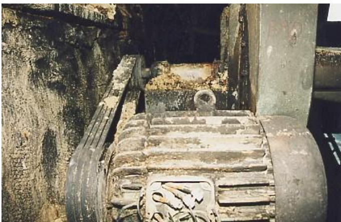
Drivpaket intakt efter branden. Observera rester av spån och damm vid drivaxel.
