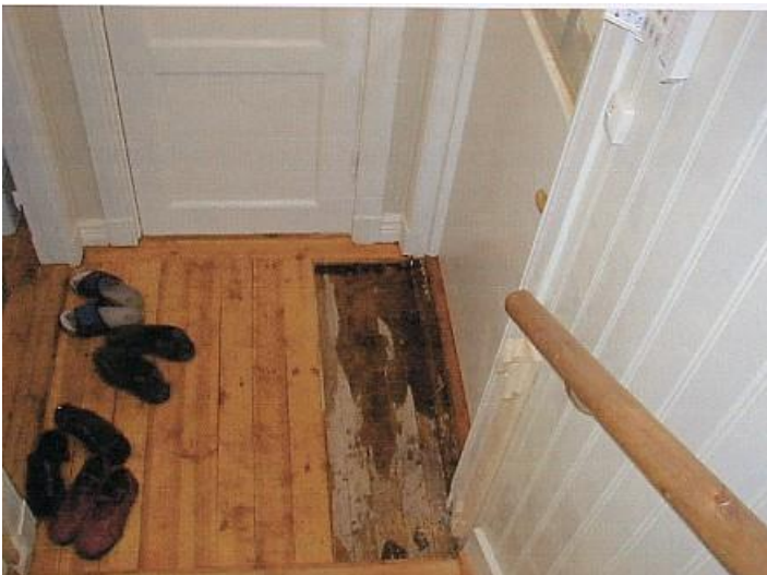
Det uppbrutna golvet med fuktfläcken från golvoljan synlig på råsponten.
