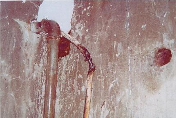
Den skadade elledningen.
