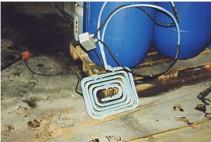
Bilden visar en doppvärmare av samma typ och fabrikat.
