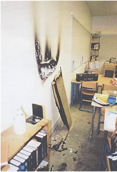
Brandskadorna begränsades till en anslagstavla samt en bokhylla.
