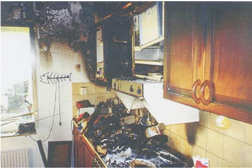
Bilden visar brandens spridning från spis mot vänstra sidan av köket.
