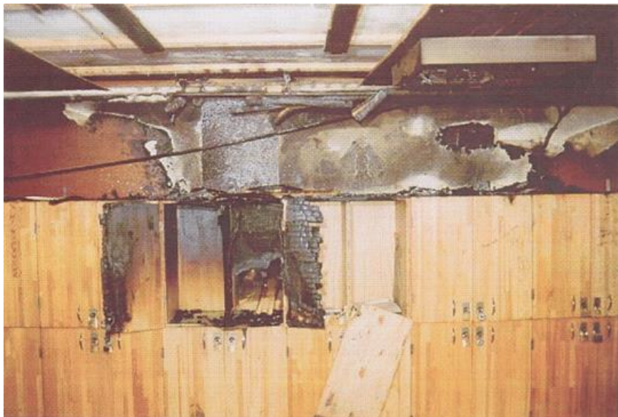
Bilden föreställer förvaringskåpen i källaren där branden startade.
