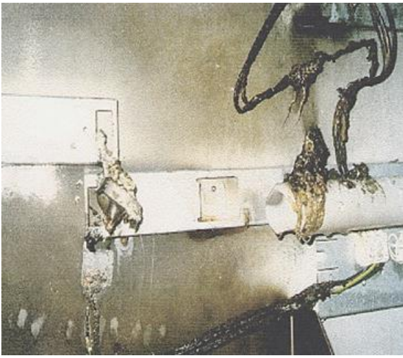
Visar skadad elkabel, samt nerdroppad plast på lysrör.
