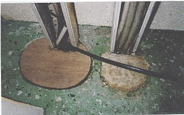
Kabelgenomföringar i golv.
