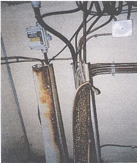
Visar brandpåverkade plastskydd för el-kablar.
