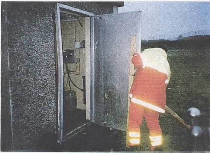
Visar utbuktningen på karm. Dörren har satts på plats efter explosionen.
