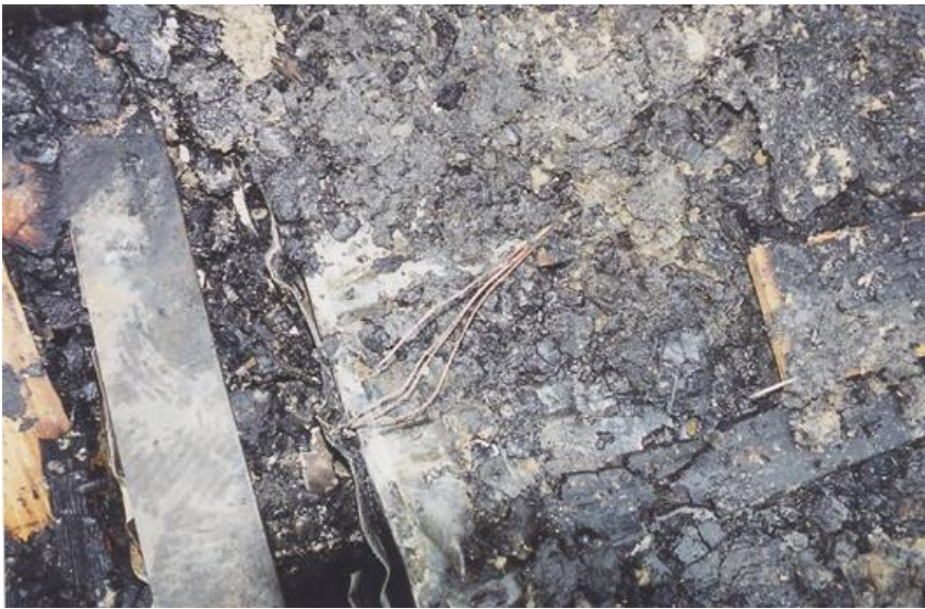
Kabeln kommer från tillslaget lysrör.
