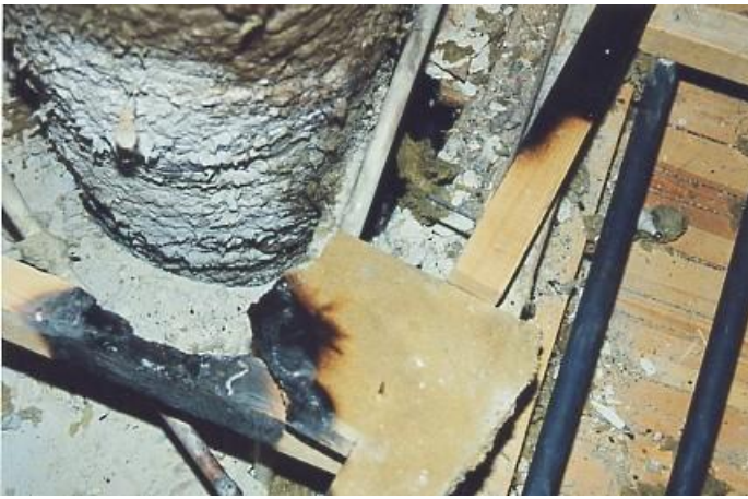
Förkolnade, oskyddade träreglar mot vilka schaktets väggar varit infästa i golvet (sovrummet, plan 2).
