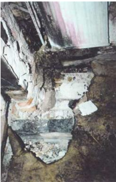
Fotot är taget i hallen mot väggen till garderoben och visar brandskador i bjälklaget under vattenradiatorn och mitt för entrédörren.
