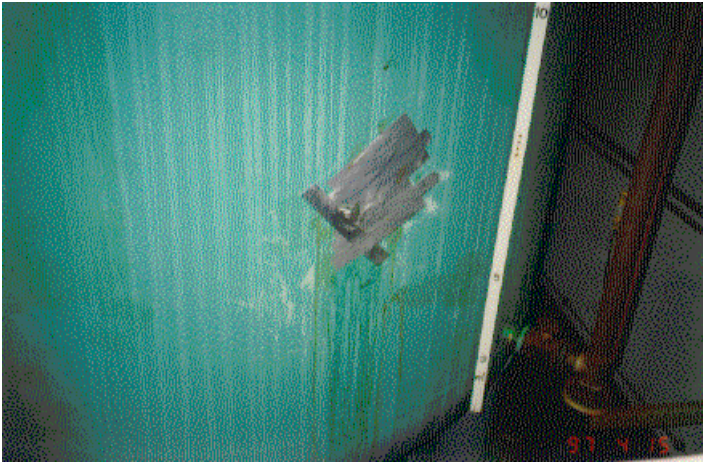
Saltsyra tank 28 kvadrat meter. Hålet ca 4 m upp på tanken
