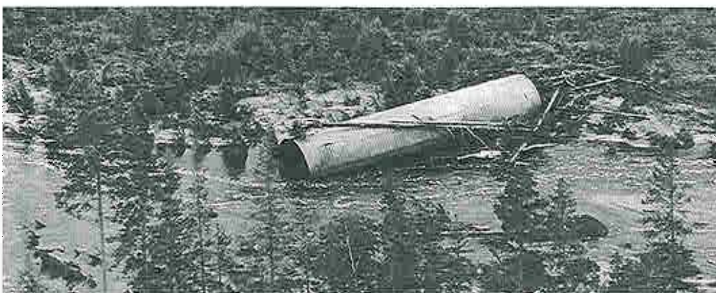
Bild 4. En vägtrumma har spolats bort från Brändängsbäcken. Foto Gunnar Westergren.
