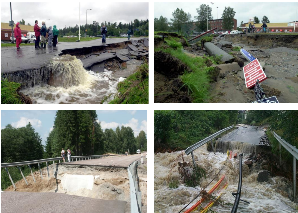
Figur 3 Exempel på fotografering av skador i samband med översvämning och som det ser ut en tid efteråt. Samtliga bilder visar skador i samband med skyfall. De övre bilderna är från trakten av Sundsvall 2001, bilden underst till vänster från Hagforstrakten 2004 och bilden till höger från Orust 2002.
