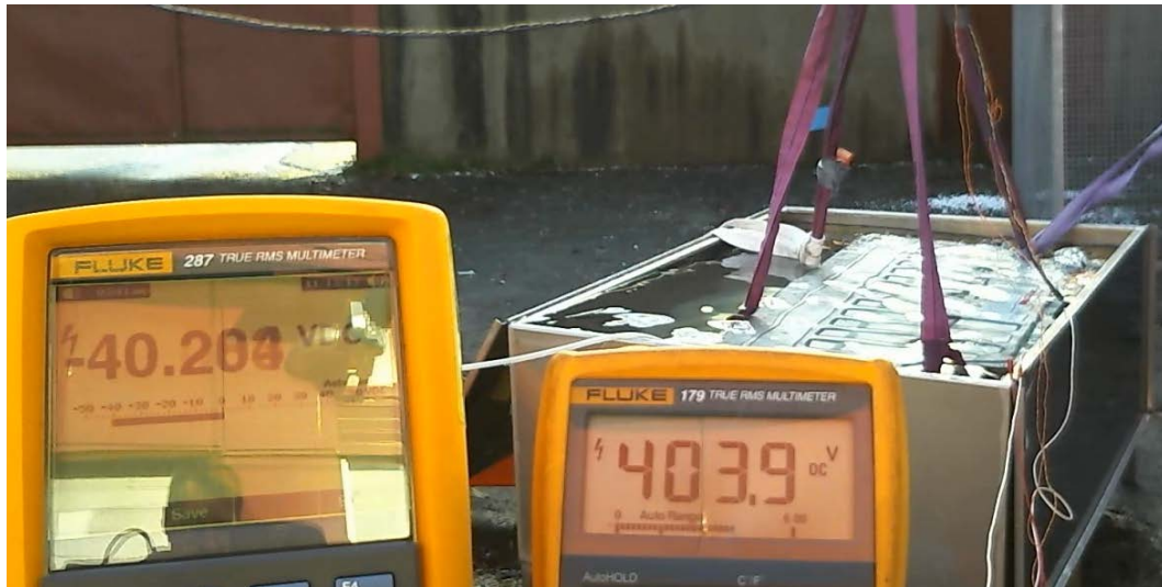
Bild 5 Batteriets inbyggda system öppnar huvudkontaktorerna omgående, mätinstrument till vänster är anslutet efter huvudkontaktorerna och instrument till höger före dessa.
