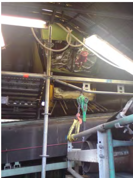
Bild 1: Här syns tätningen med mineralull i bottenutloppet i den ene av cisternens två koner.
