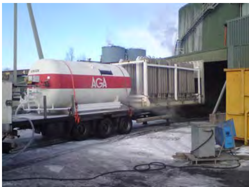
Bild 6: Uppställning av förångare
