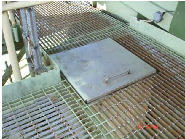
Bild 2: befintlig lucka på toppen av cisternen som öppnades och användes som avluftning/backventil med en gummiduk över.
