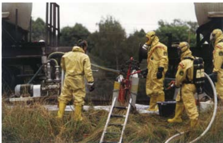
Överpumpning av salpetersyra vid en järnvägsolycka.
