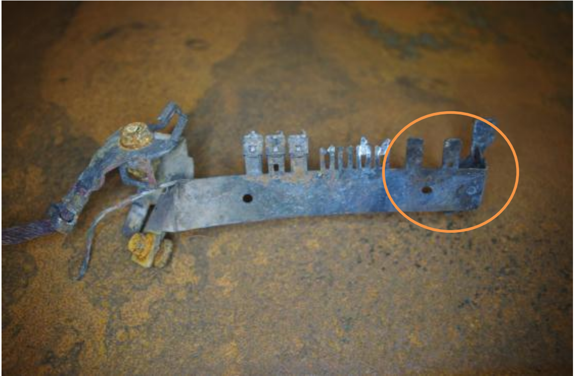
Bild 15 Fördelningsplint för +30 där batteriets matande kablage kan ses till vänster och ljusbågsskada till höger i bild.
