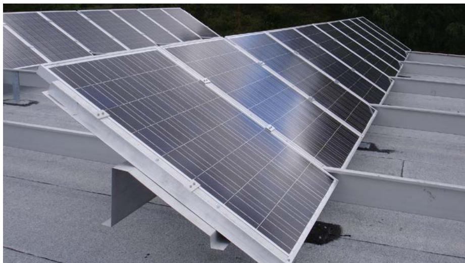
Exempel på en solcellsanläggning
