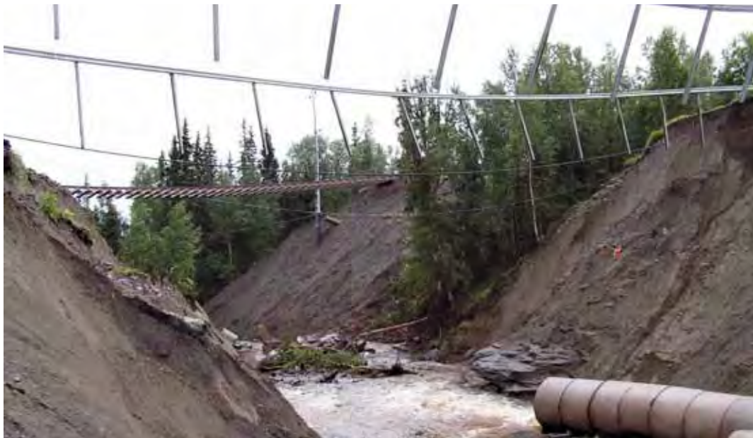
Väg- och järnvägsbanken rasade i samband med extrem nederbörd i Ånn sommaren 2006.
