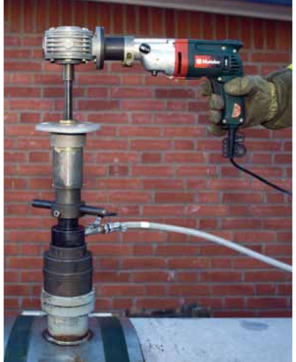
Håltagning i tank, observera att bormaskinen inte är ex-klassad.
