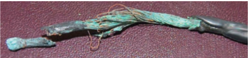
Bild 40. En ledare som varit inkopplad genom en jordfelsbrytare där glappkontakt uppstått.
