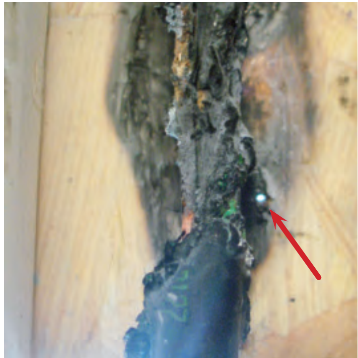
Bild 123. En bit av det blå plaströret syns i bildens nederkant. En pil visar hålet där skruven har trängt in i väggen och startat branden.
