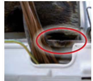
Bild 103. Det har blivit en urgröpnung i metallkanten där den varit i kontakt med de strömförande ledarna. Ledarna och metallkanten syns i den röda ringen.
