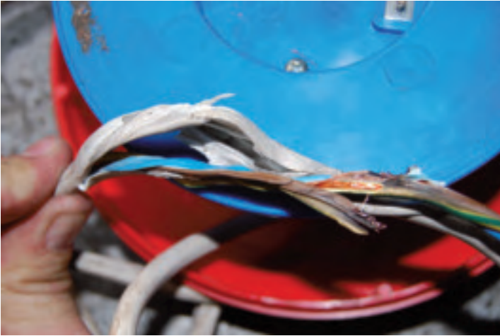
Bild 47. En kabel som har utsatts för överbelastning. På kabeln syns att isoleringen har smält runt ledarna i kabeln och att de inte längre har en rund form. Ledarna har också svärtats på ett område som var innanför den vita yttre isoleringen. Den vita isoleringen var mest skadad på insidan. På bilden har isoleringen skurits upp.
