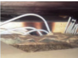
Bild 112. Rören som dragits upp ovanför isoleringen och som i förlängningen orsakat branden i villan.
