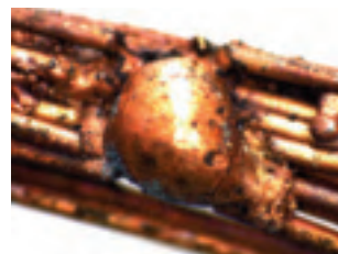
Bild 61. Kortslutningsskada på den andra ledaren.
