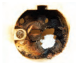
Bild 115. Hålet i locket till vägguttaget visar tydligt var glappkontakten varit.
