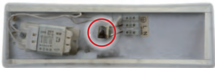
Bild 64. En armatur där det varit ett brandtillbud i kondensatorn, orsakat av överspänning. Ett avbrott i PEN-ledaren visade att överspänning hade orsakat branden.
