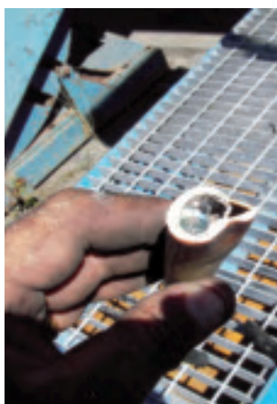
Bild 63. Kabeln som det uppstått kallflytning i. Som syns på bilden är de metalliska ledarna nära varandra.
