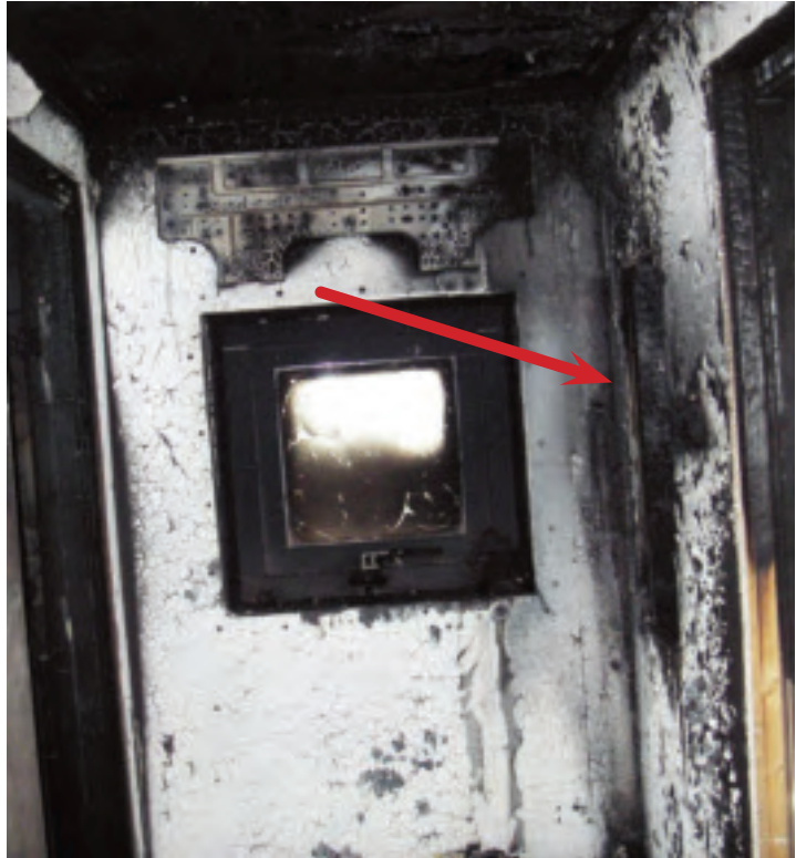
Bild 111. Som syns på bilden är rummet kraftigt brandskadat och utifrån brandbilden är det svårt att avgöra var i rummet branden började. Det syns att branden varit kraftig och att brandskadorna är låga. Med anledning av att en brand sprider sig mycket snabbare uppåt än nedåt är det alltid intressant att undersöka de lägsta brandskadorna för att se om branden börjat där.
