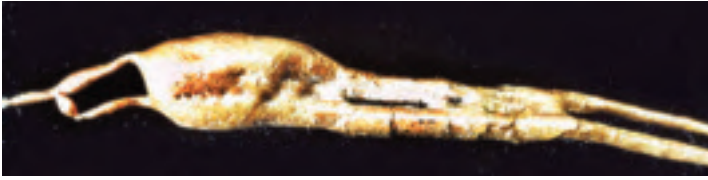
Bild 68. En brandvärmeskada som uppstått mellan två stycken enkardeliga kopparledare.
