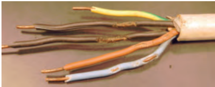
Bild 50 B. En kabel där det har uppstått överledning. En mus eller råtta har förmodligen gnagt på ledarna. Smältskador i form av små bubblor syns på några av ledarna.
