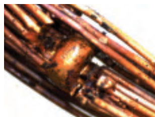
Bild 60. Kortslutningsskada på en ledare.
