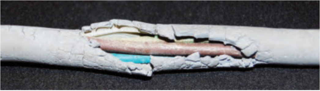
Bild 120. En ledning med gummiisolerings som börjat falla sönder på grund av åldrande.
