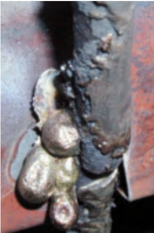
Bild 50 A. Skador som har orsakats av ljusbågar. För att hindra brandutvecklingen krävdes att strömmen bröts till ledningen. En jordfelsbrytare hade sannolikt brutit strömmen vid den här skadan.
