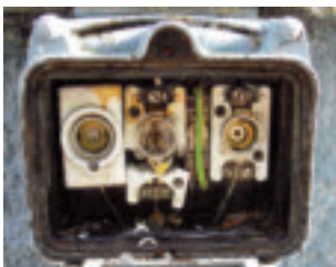
Bild 67. Ledningarna som delvis lossnat vid dränering. Som syns på bilden har plinten till PEN-ledaren överbryggs, vilket förmodligen beror på att det varit dålig kontakt.
