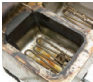
Bild 128. En närbild på fritösen som det börjat brinna i.
