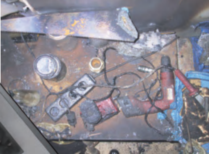
Bild 173. Denna bild är tagen vid område 5 och visar diverse elektrisk utrustning som var intressant att utreda för att kunna utesluta eller fastställa föremålen som brandsorsak.
