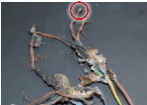
Bild 43. En elkabel där en brand startat på grund av en glappkontakt. Glappkontakten syns inom den röda cirkeln.
