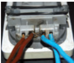
Bild 77. En överledning som uppstått i en plast mellan fas och nolla i ett eluttag.
