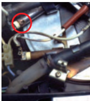
Bild 45. Kaffebryggaren där jordfelet uppstod. Platsen där detta inträffade visas av den röda cirkeln.
