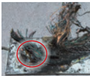
Bild 92. En lysrörsarmatur där det börjat brinna i en drossel. Branden har börjat i området som markeras med en röd ring. Branden orsakades av en varvkortslutning i drosseln.
