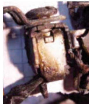
Bild 107. Skruven som inte varit åtdragen i automatsäkringens.
