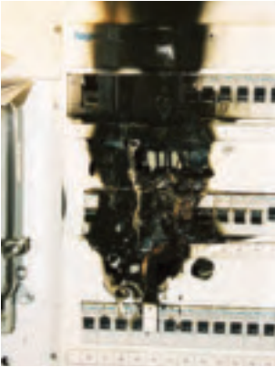
Bild 110. Elcentralen där det börjat brinna på grund av en vattenläcka.
