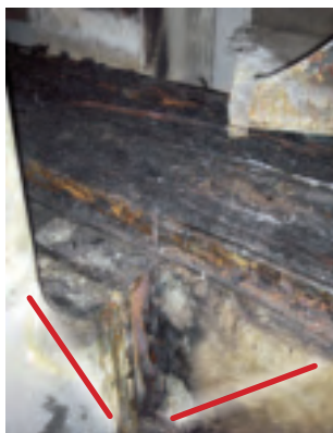
Bild 62. Brand-V:et visade var den troliga primärbrandplatsen fanns. I överkant på bilden syns en kabelstege som är kraftigt bränd.
