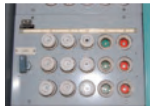
Bild 25. En gängsäkringscentral med två olika typer av bottenkontakter för säkringar med olika strömstyrkor (röda och gröna).
