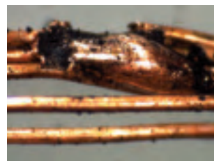
Bild 59. Kortslutningsskada på den andra ledaren.
