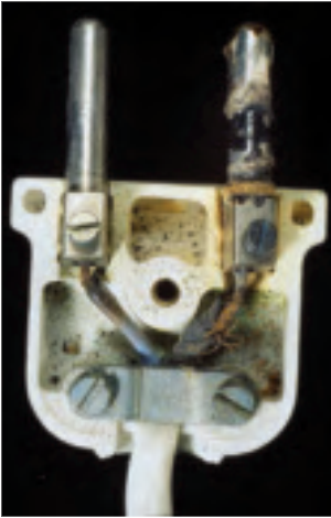
Bild 38. En stickpropp där glappkontakt uppstått. Den högra anslutningen visar tydliga smältskador efter värmeutveckling. En glappkontakt har även uppstått i den vänstra anslutningen som har smältskador och missfärgad isoleringen på ledaren. Glappkontakt har uppstått på båda ledarna.
