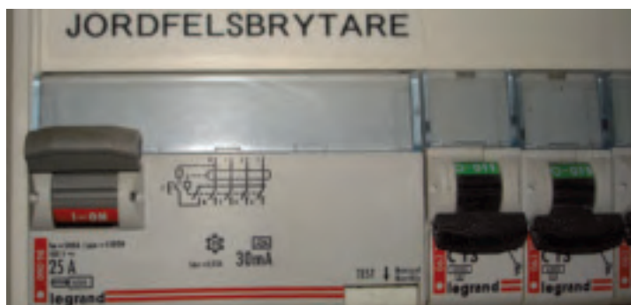
Bild 9. En jordfelsbrytare som är tillslagen och som är fast installerad i gruppcentralen 28 . Jordfelsbrytaren löser ut vid 30 mA och bryter då alla tre faser och neutralledaren.
