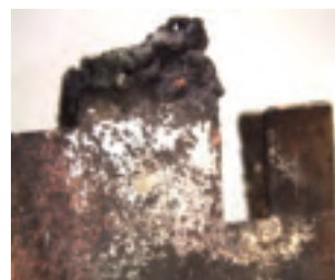
Bild 116. Anslutningsblecket (hylsan) i vägguttaget har smält vid glappkontakten. Bilden visar en förstoring på hylsan som finns i ringen på bild 114.
