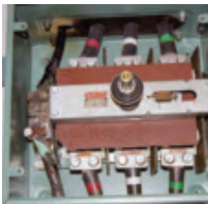
Bild 65. Brytaren för huvudledningen (stigarledningen). Till vänster syns PEN-ledaren där avbrottet var. Ledningarna är smälta på båda sidor om kopplingen vilket visar att det varit en glappkontakt.
