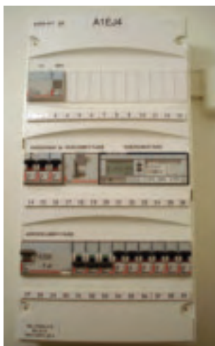
Bild 24. En normcentral som utgör en gruppcentral i en lägenhet. Gruppcentralen är från en lägenhet som byggdes på 1930-talet och därmed finns en elmätare i centralen.
