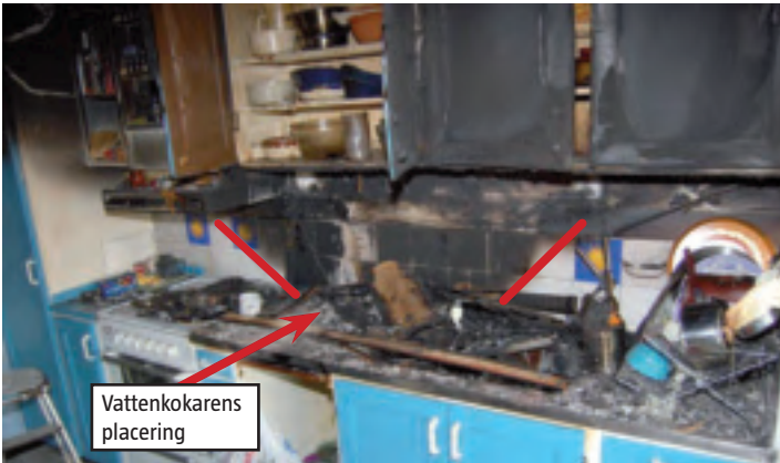
Bild 153. Ett tydligt brand-V syns på bilden, markerat med två röda linjer. Vid en närmare undersökning syns ett vitt område på kaklet i brand-V:et som visar att det varit varmare där än runt omkring. Där stod också vattenkokaren. På undersidan av bänken där vattenkokaren stått fanns kraftiga brandskador.
