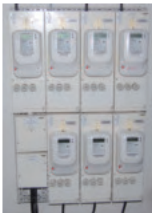
Bild 23. Mätartavlor i ett trapphus i ett flerbostadshus.
