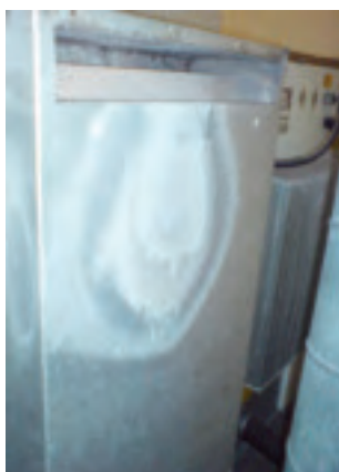
Bild 146. Det syns tydligt att det varit varmt på insidan av skyddsplåten på torktummlarens baksida.
