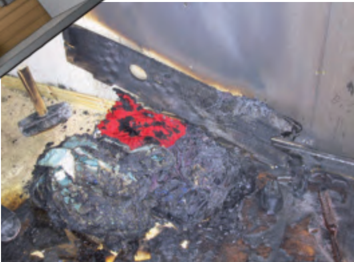
Bild 174. Denna bild är tagen vid område 4 och visar brandskador längs med långsidan som är på motsatta sidan mot arbetsbänken. På platsen fanns ett område med kraftiga brandskador på golv och vägg.
