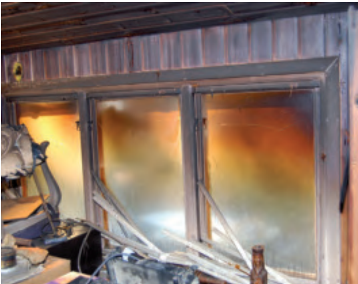
Bild 31. Fönster som tjära samlats på i samband med en brand som varit ventilationskontrollerad.
