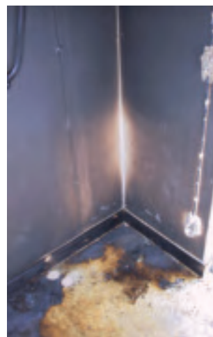
Bild 170. Denna bild är tagen vid område 3 och visar brandskador direkt till höger innanför dörren.
