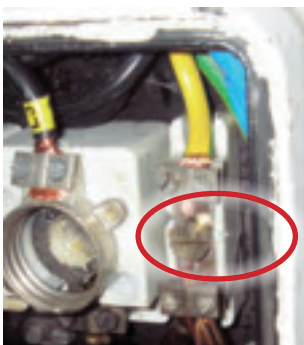
Bild 66. En koppling för en PEN-ledare där porslinet har spruckit, vilket lett till en brand i en bostad. Vid detta tillfälle har isoleringen lossnat på den undre PEN-ledaren för att den var gammal. Detta hade dock inget med brandsaken att göra vid detta tillfälle.
