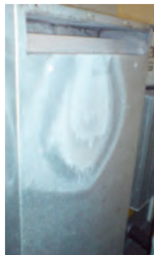
Bild 48. Baksidan av en torktumlare där det börjat brinna på grund av överhettning. I detta fall hade kontaktorn fastnat i slutet läge till värmeelementen och de hade varit påslagna hela tiden. Det syns tydligt att det varit varmt på insidan av skyddsplåten.
