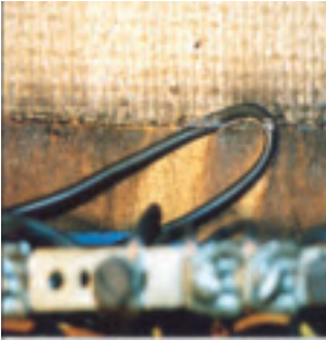
Bild 49. En ledare som blivit klämd mellan väggen och kåpan till en elcentral. Den skada som uppstått på kabeln skulle ha kunnat orsaka en brand.
