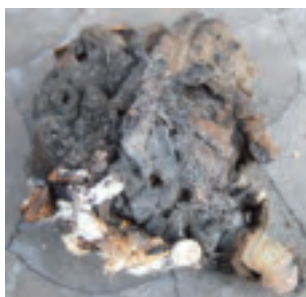
Bild 167. En del av pumpen som hade mycket kraftiga brandskador.
