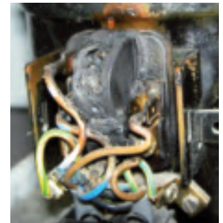
Bild 134. Ett startrelä där det har brunnit.
