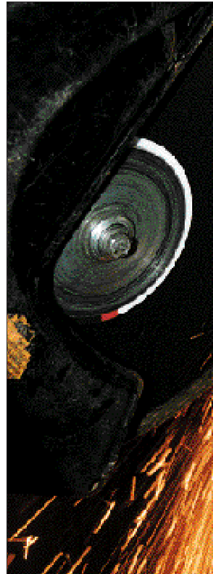
I Malmö använder brandmännen kapmaskin för att snabbt forcera dörrar. Överfalsen på dörren snittas och viks bort. Därefter kan låskolvarna kapas och dörren öppnas. Det fungerar även på klass 3-dörrar.
