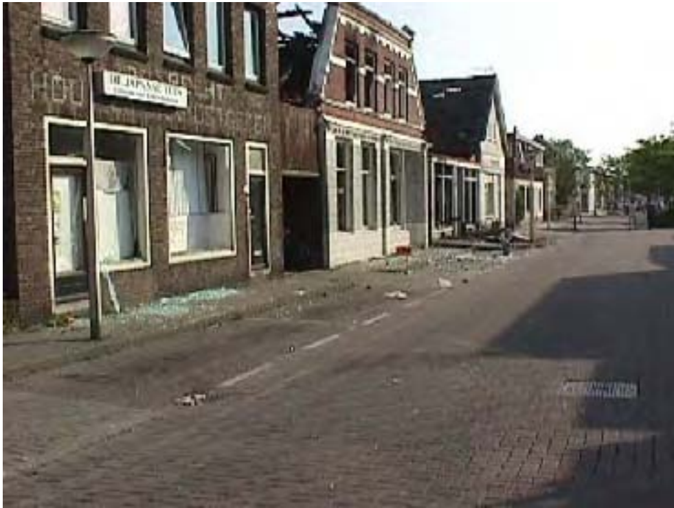
Byggnader som blåsts ur av tryckvågen från explosionen. FOTO: HENK DERKSEN
