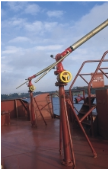
Tungskumsrör på däck
