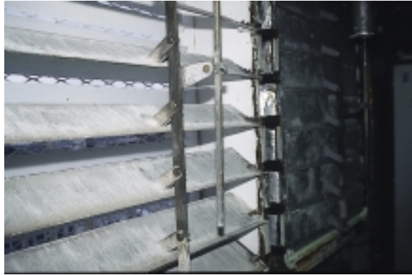
Brandspjäll från kompressorum
