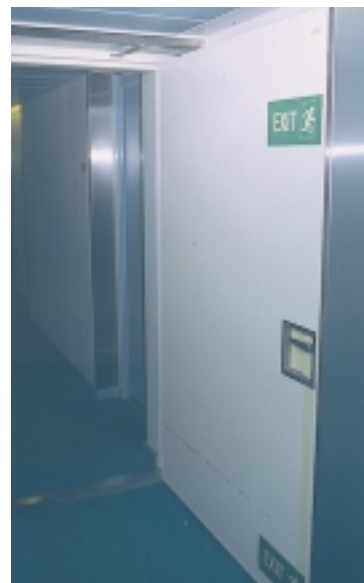
Branddörr i korridor
