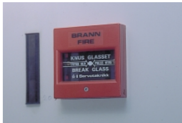
Manuell tryckknapp för brandlarm
