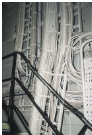
Risken för brandspridning via elkablar är stor
