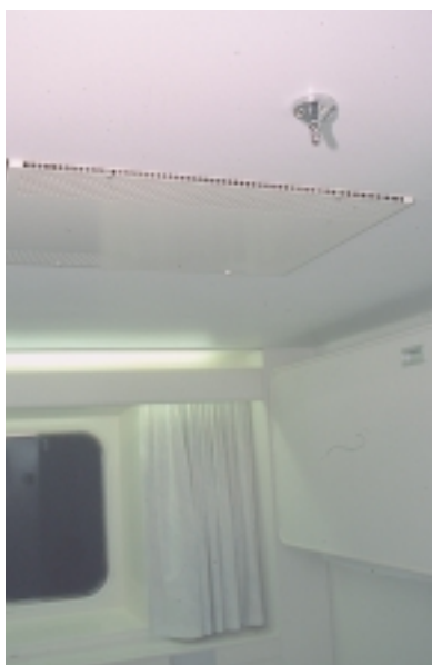
Ventilation i hytt
