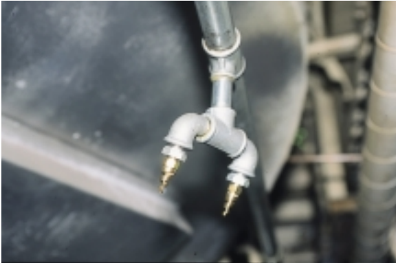
Sprinklerhuvud i maskinrum
